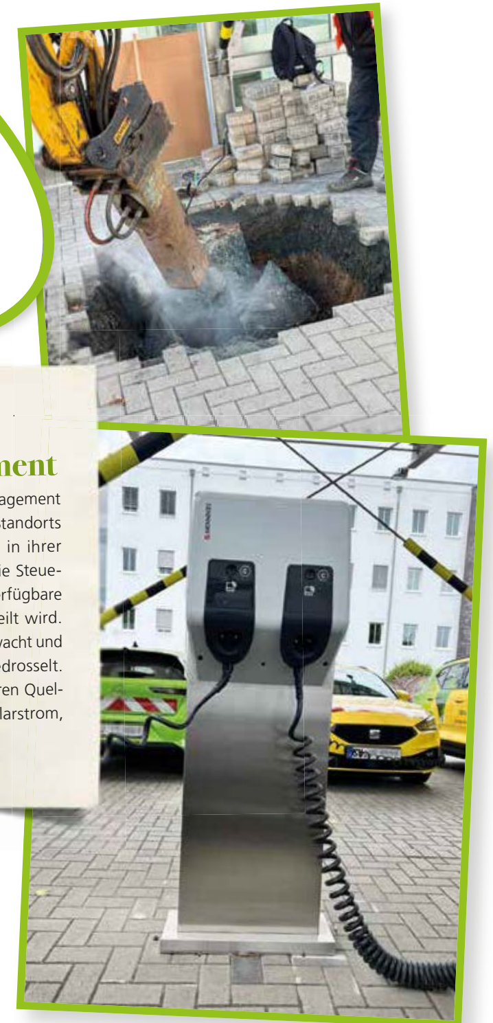
Die Ladesäulen auf dem Betriebshof der Stadtwerke wurden erneuert und intelligent vernetzt.
