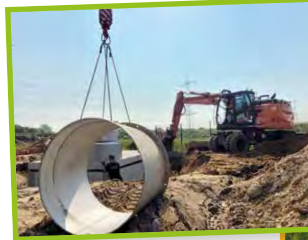
Die zentral für das gesamte Baugebiet eingerichtete Brunnenstation wiegt 49 Tonnen und bildet das Herzstück der lokalen Nahwärmeinfrastruktur. So ist künftig die CO 2 -freie Wärmeversorgung der Anwohner gesichert.
