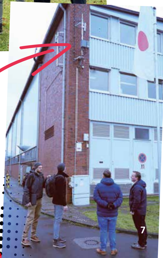
5G-Antennenanlage im IndustrieStadtPark.
