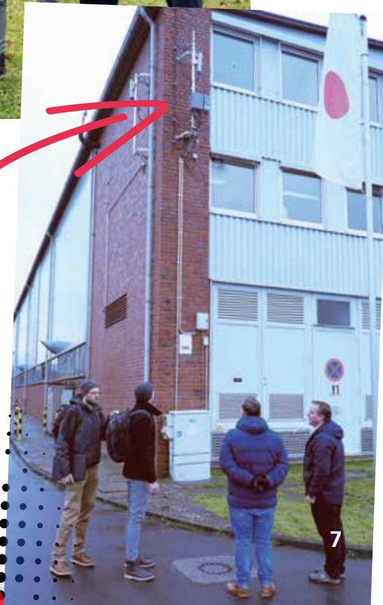
5G-Antennenanlage im IndustrieStadtPark.
