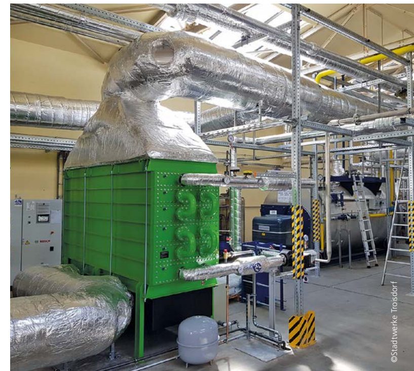
Blick in die Dampfzentrale mit integriertem Hocheffizienzwärmetauscher
