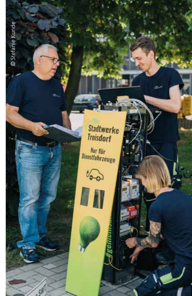
Überall in Troisdorf installieren die Stadtwerke Naturstrom-Ladesäulen für E-Autos.
