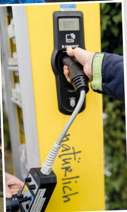
Zum Start in den Tag: Wartung einer Ladesäule auf dem Betriebshof der Stadtwerke Troisdorf.
