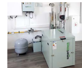
Heizen mit Wasserstoff Seite 20
