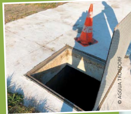
Auch die Schwallwasserbehälter müssen saniert werden.
