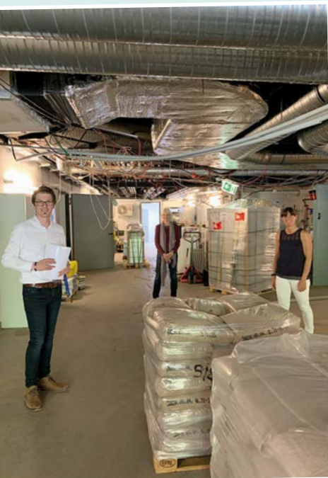
Rotraut Walder von der VHS Troisdorf und Daniela Ritter vom Troisdorfer Turnverein überzeugen sich bei einem Rundgang mit AGGUA-Geschäftsführer Martin Roth vom Fortschritt der Sanierungsarbeiten.
