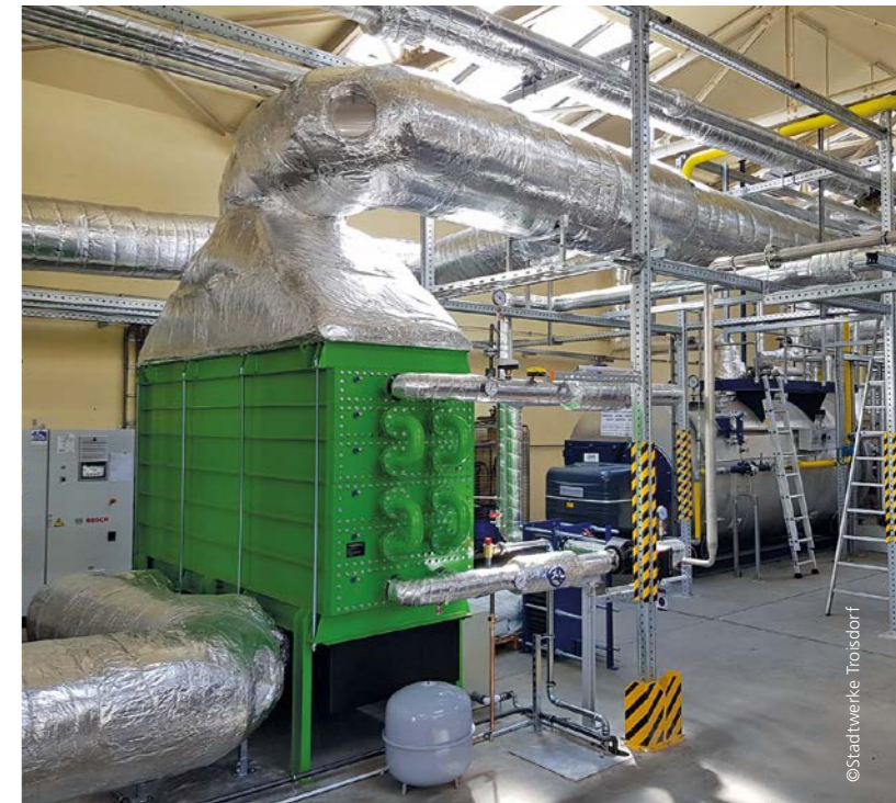
Blick in die Dampfzentrale mit integriertem Hocheffizienz-Wärmetauscher
