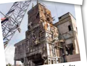
Vor rund zehn Jahren wurde das stillgelegte Kraftwerk zurückgebaut. Heute steht an seiner Stelle die moderne Firmenzentrale eines innovativen Unternehmens.
